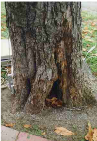
Abbildung 9 Gefahr: Tiefreichende Höhlung und keine Abgrenzung zwischen abgestorbenen
